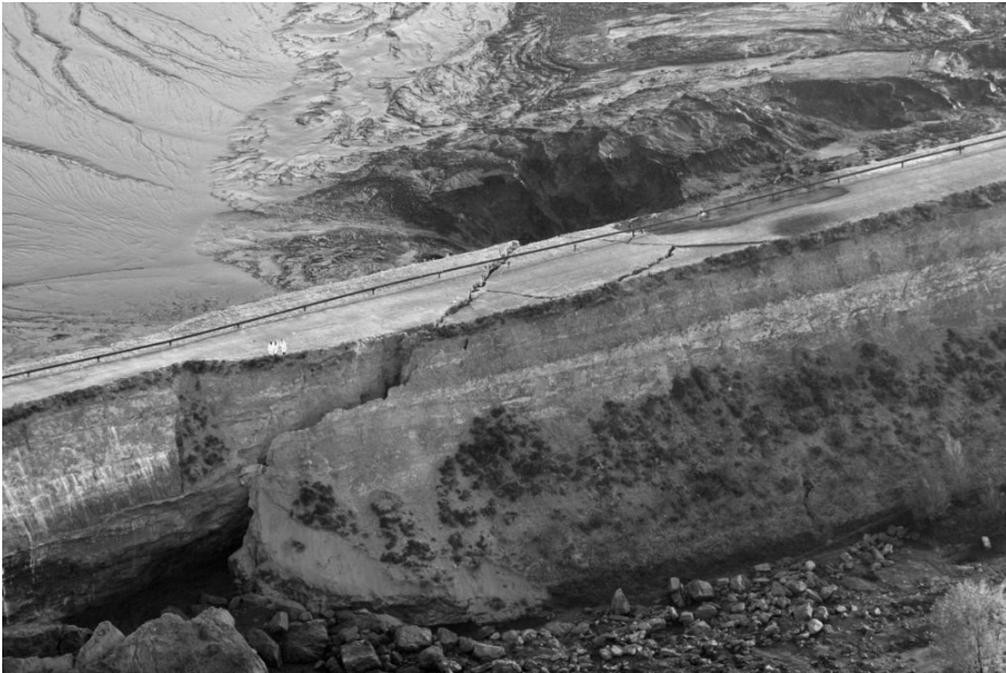
Ein zweiter Riss im Damm
